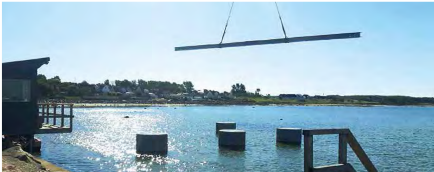
De nya balkarna lyfts på plats under det fantastiska vädret som naturligtvis underlättade byggnationen av den nya bryggan.
